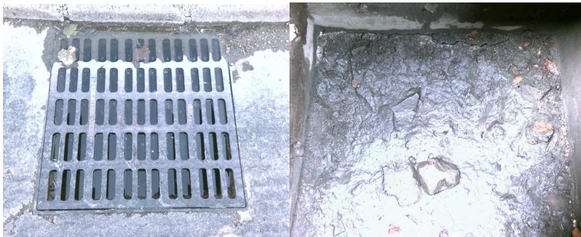
Figure 26 : Obstruction des ouvrages d'évacuation des EP
