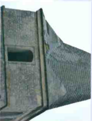
Etat de la couverture du clocher d'Allainville
