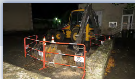
Puisard en face du cabinet du médecin généraliste et des infirmières afin d'éviter les inondations
